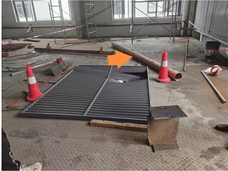
王某某坠落的设备预留孔及踩踏的百叶窗
