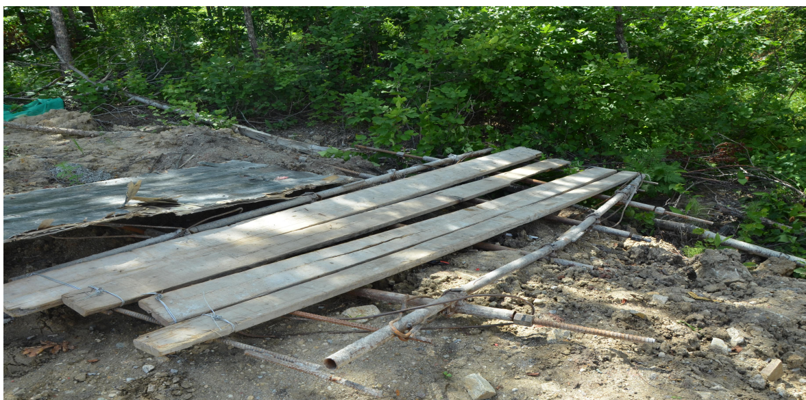
图 8 被砸翻的桥墩内部作业平台
