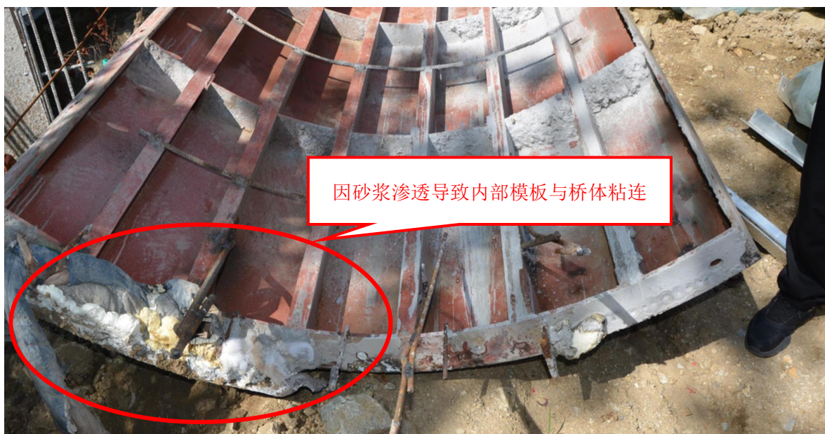
图 7 9#桥墩掉落的内倾覆模板及与桥体粘连处
