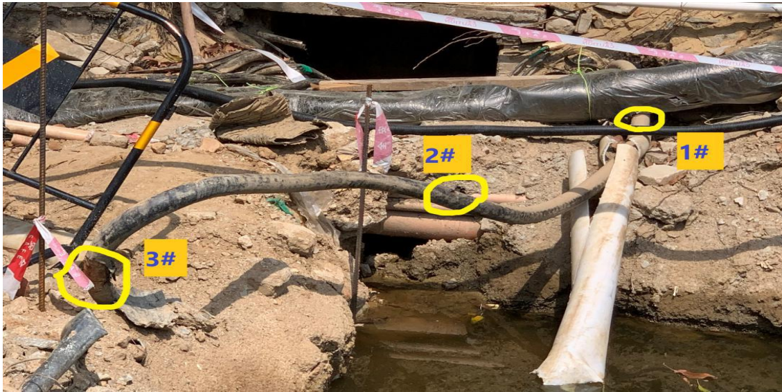
图 3 漏电段电缆破损点
