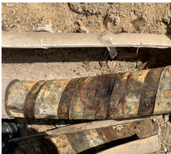
图 6 涉事电缆 1#点钢铠伤口图
