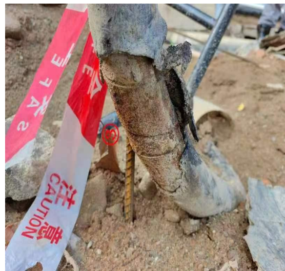
图 5 电缆外护套 3#破损点
