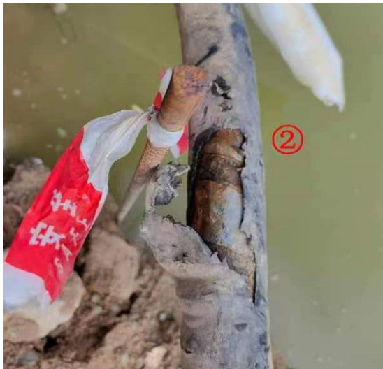
图 4 电缆外护套 2#破损点
