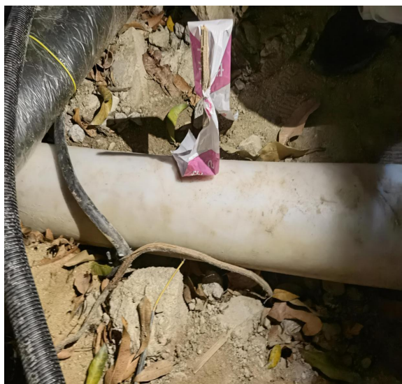
图8 涉事电缆1#点处PVC套管
