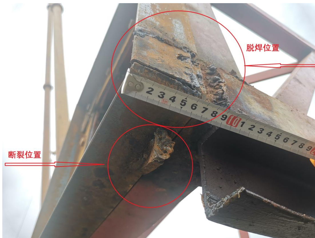
图四 脱焊、断裂痕迹
