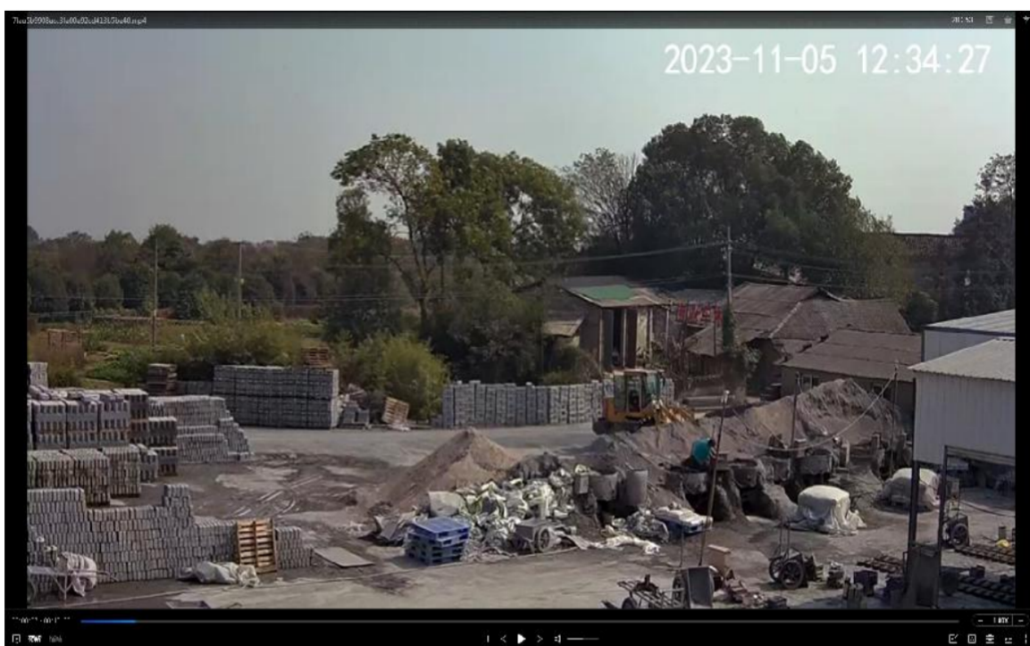
（图 3）视频监控显示的死者违规进入到搅拌机内并启动设备
