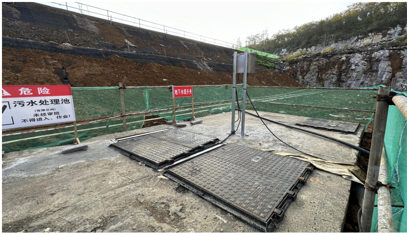
图 3：事故现场渗滤液阀门井
