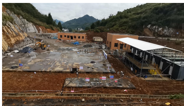
图 1：事故现场概貌
