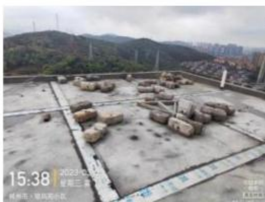
图 12 建筑物屋面配重散落现场图
