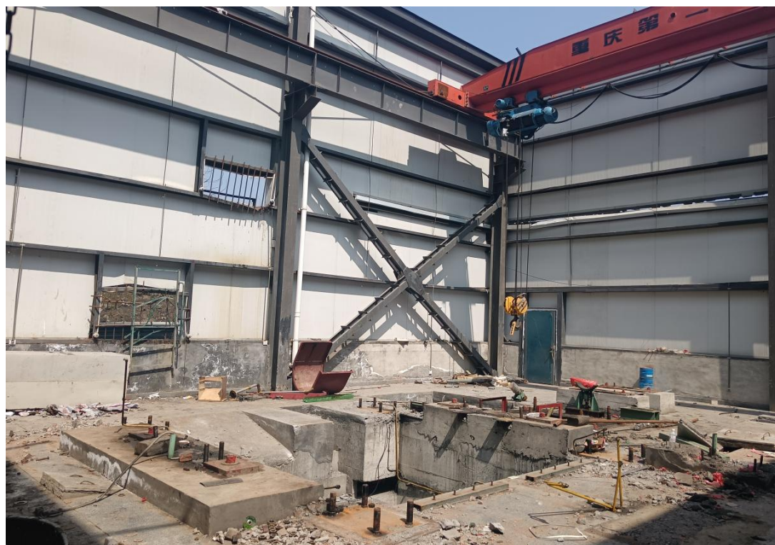
图 1 事故现场（事故发生后，地面提升机已拆除）
