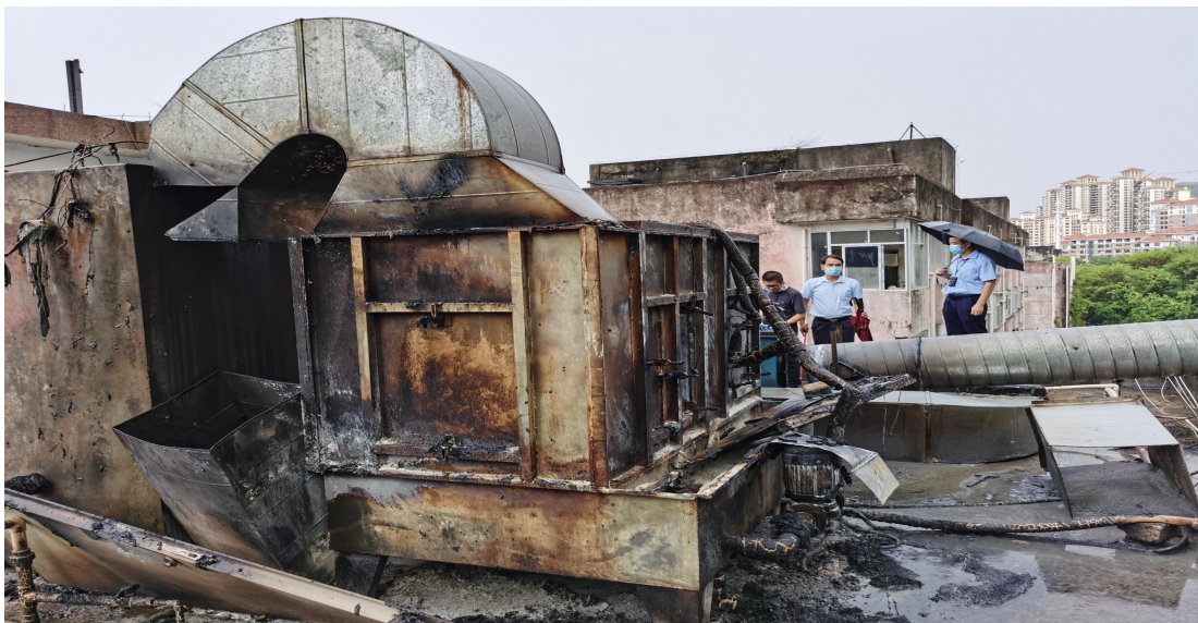
A栋楼顶天面被烧的废气处理柜
