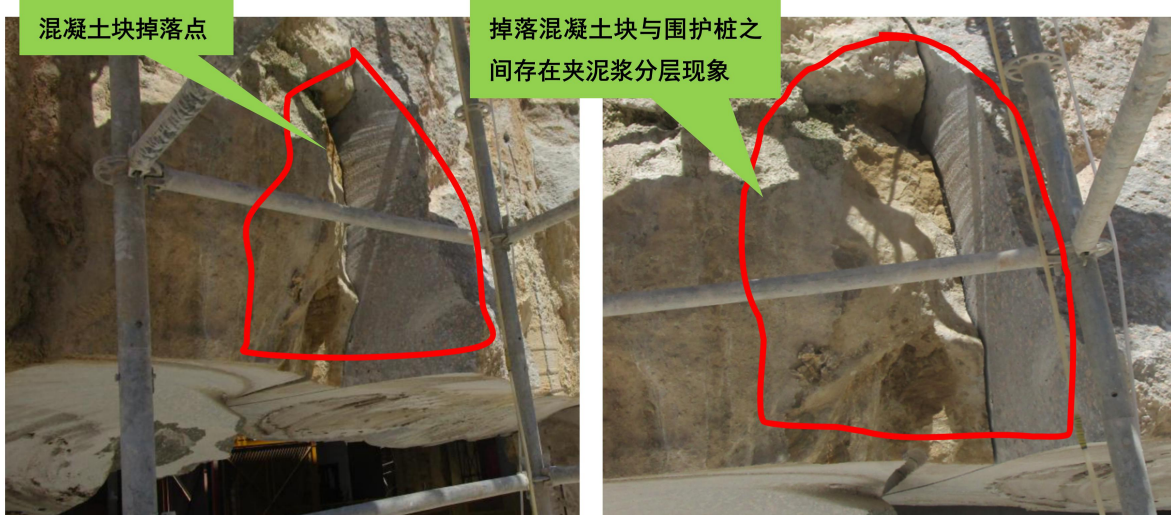
图 4：混凝土块脱落位置
