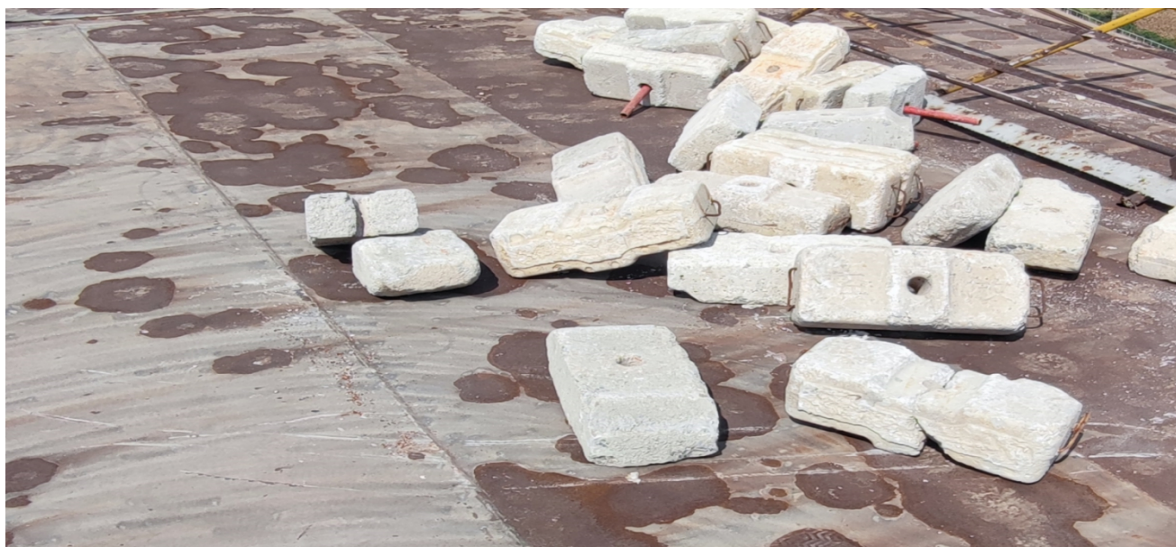
图 8：2 号吊篮左边（面向煤气柜）悬挂机构后立柱移位时与煤气柜顶的摩擦痕迹
