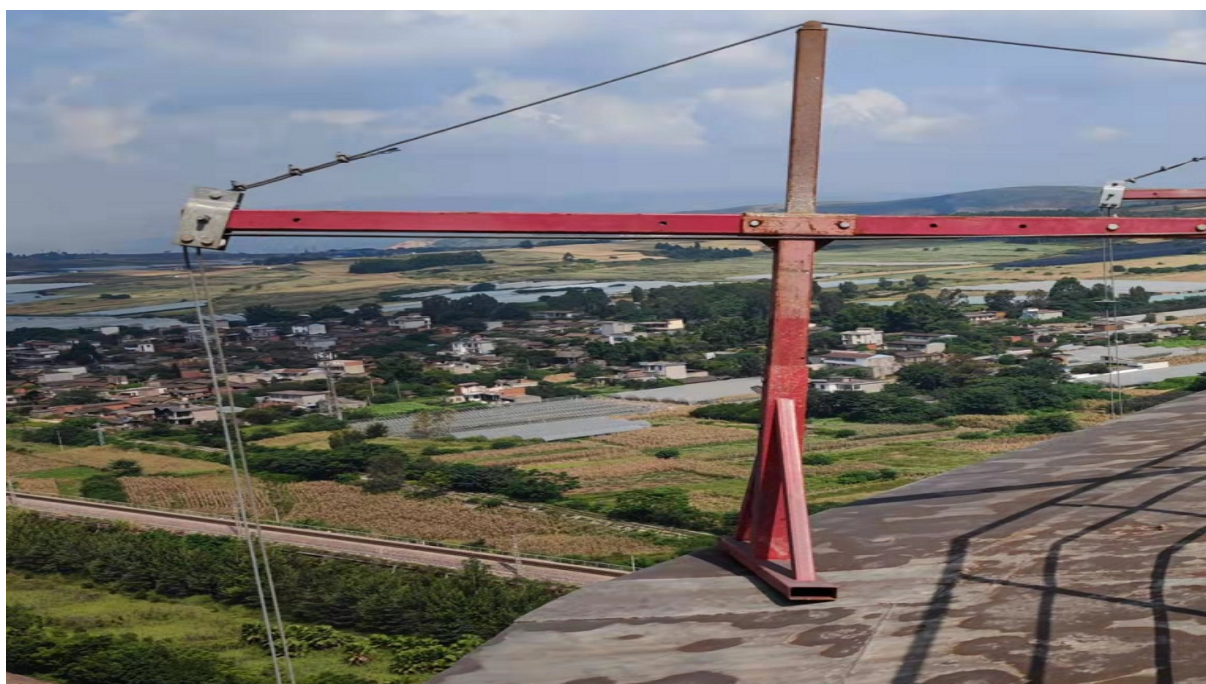
图 3：1 号煤气柜斜面屋顶安装的前立柱底面未找平
