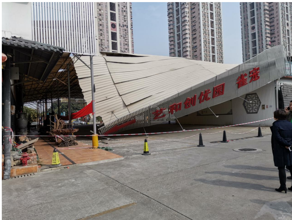
(图 3 事故现场，停车场棚架第一道横梁已割开，西南一角垮塌。)
