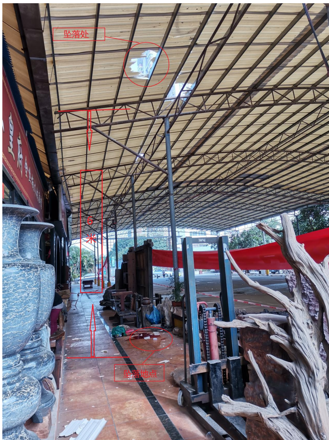
(图 5 事故现场，工人坠落位置，作业点无任何防坠落安全防护措施。)
