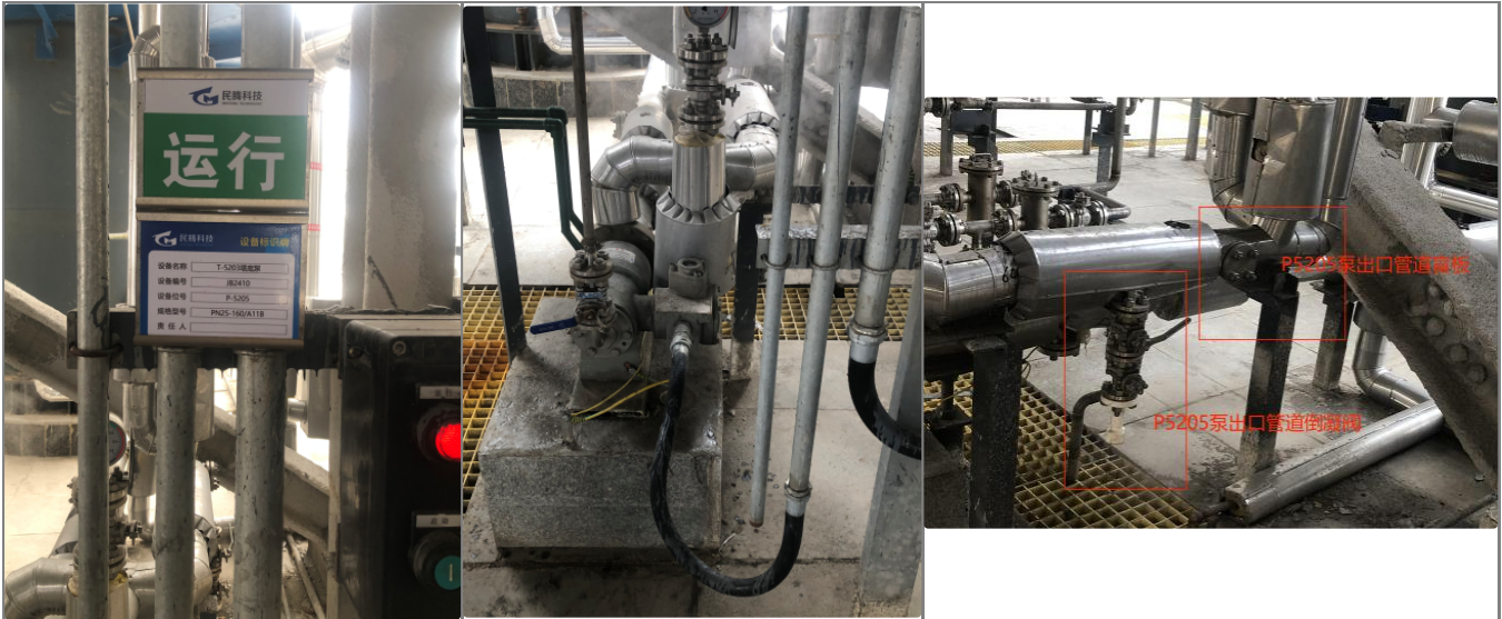
P5205运行状态牌、按钮 P5205泵体 P5205出口盲板及倒凝管
