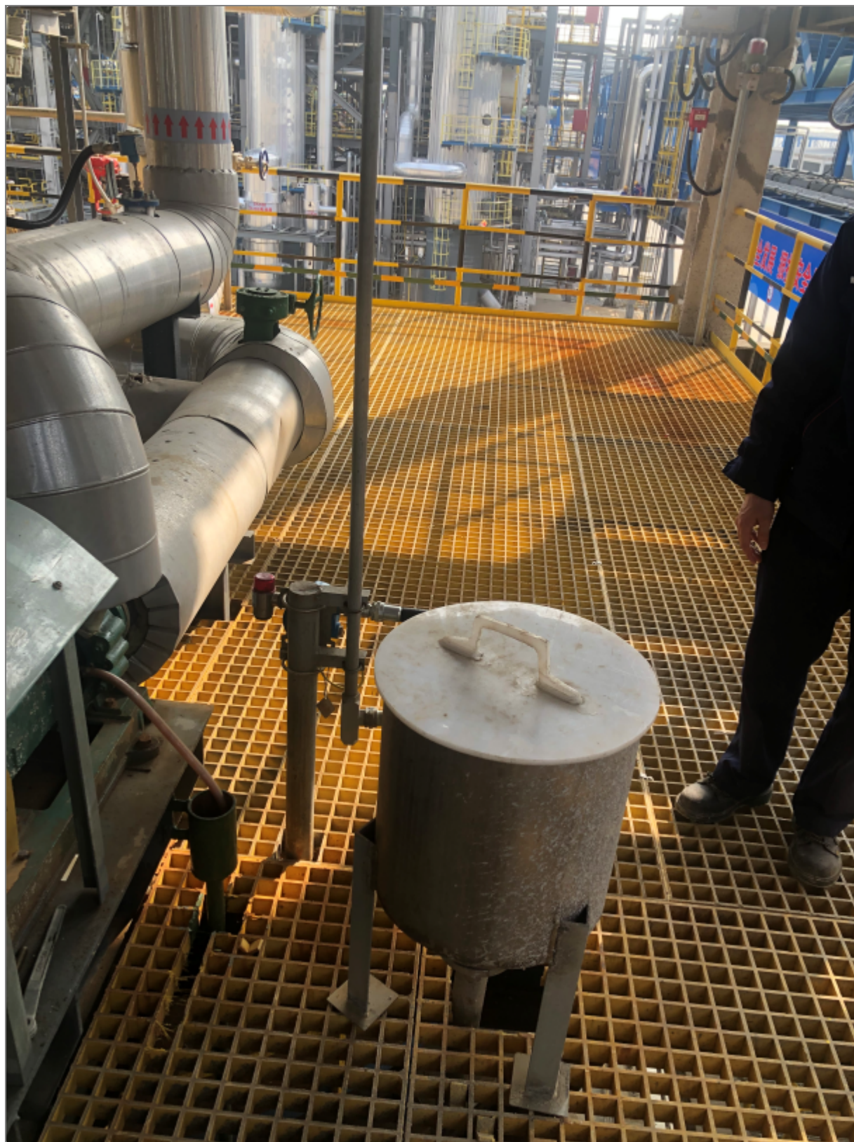
图3-2 粗ECH缓冲罐V4204样品回收斗(三楼)
