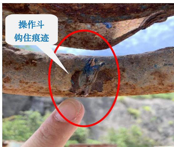
图 6 高空作业车操作斗被钩住痕迹
