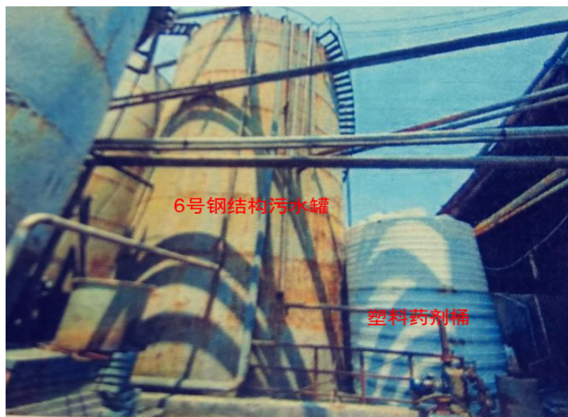
图3 事发污水罐现场图（坍塌前）
