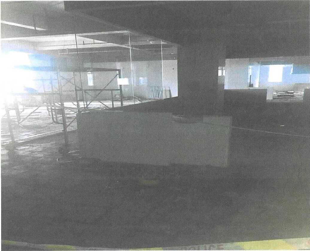
（施工事故现场照片）
