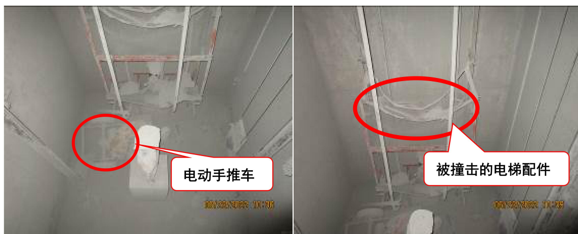
图 2：事故电梯底坑情况
