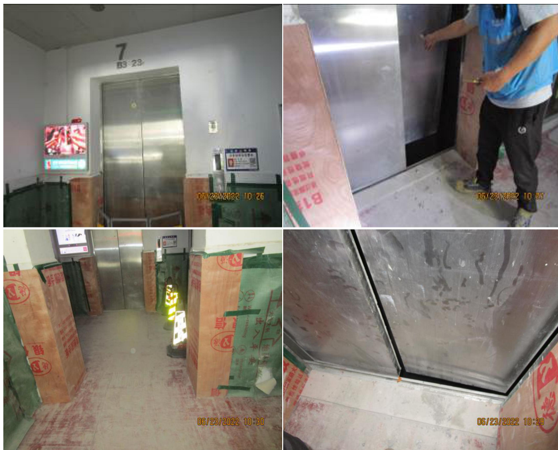
图 1：事故 7 号消防电梯
