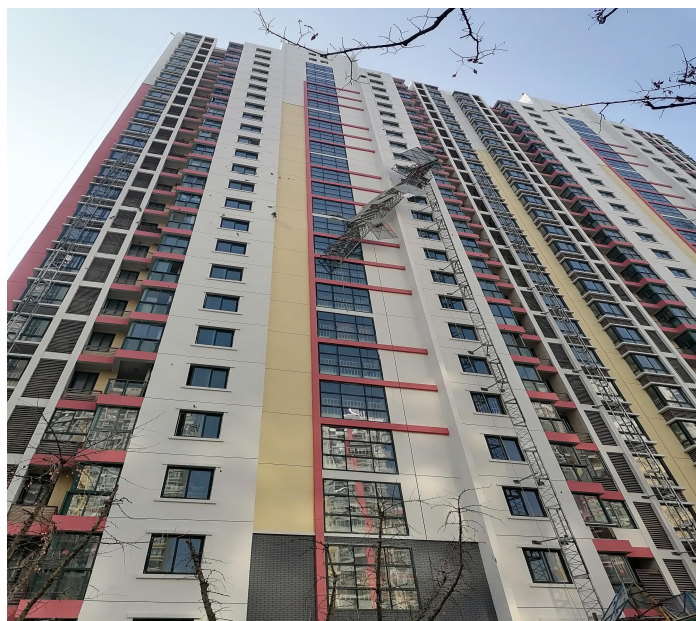
图 1 附着式电动施工平台事故现场
