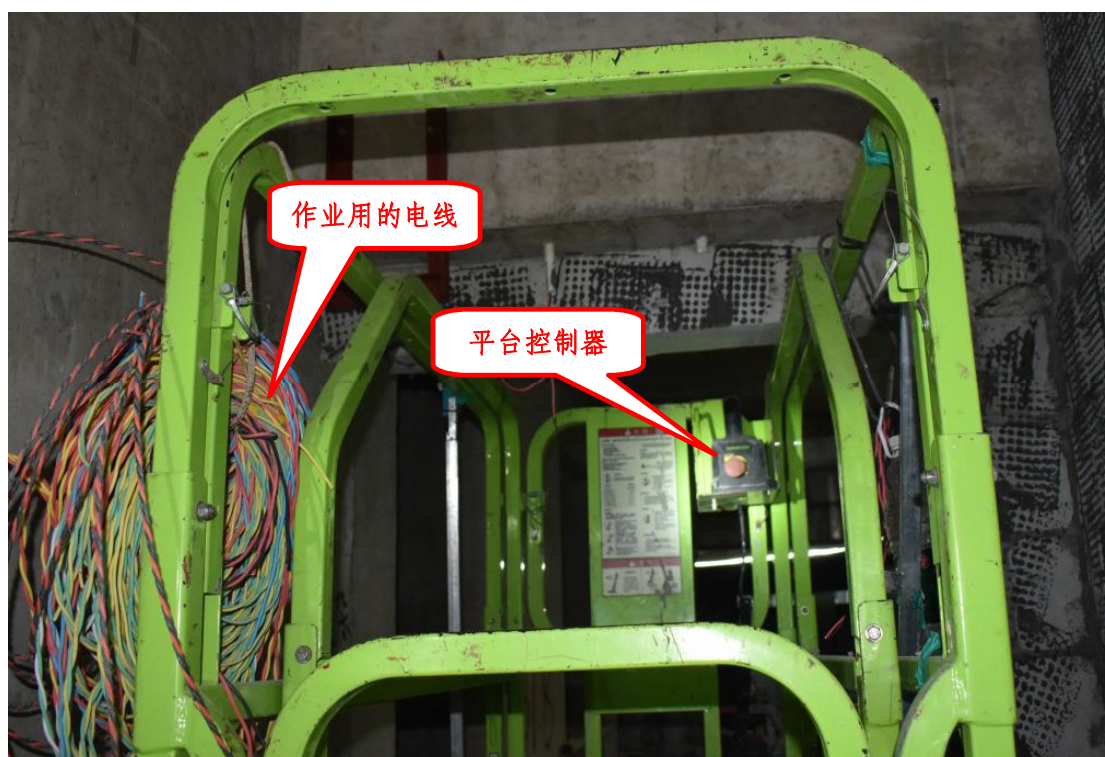
图5 涉事高空作业平台末端情况图
