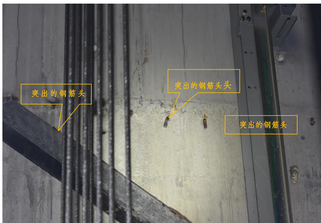
图 10 电梯井后壁上突出的钢筋头
