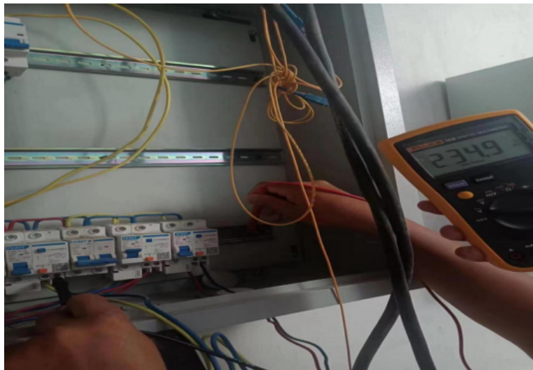
图6 1P+N漏电保护跳闸后该漏电保护器出线仍带有234.9V电压
