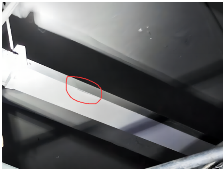
图10 金属电缆桥架上被死者头颈部触碰过的痕迹
