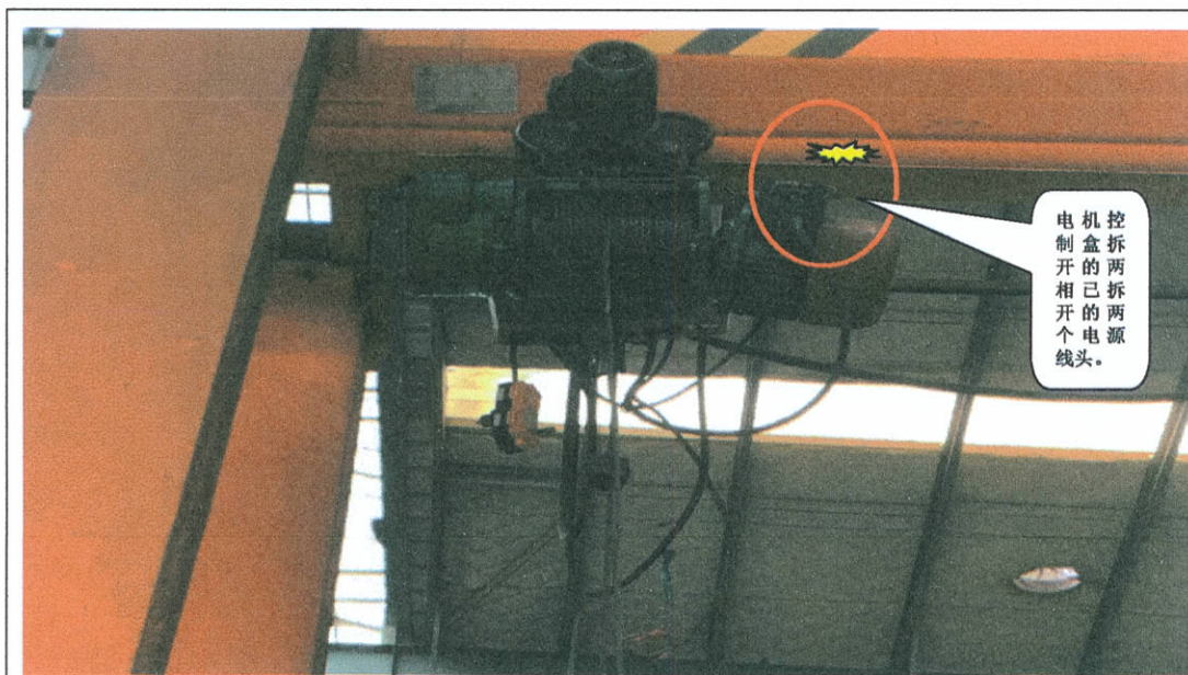
图片 15: 电机两个电源接头为维修工梁方田左手虎口“两相触电”处。与渭南中心医院出具的诊断病历“左手可见两处电击入口, 伤口局部溃烂”相一致。
