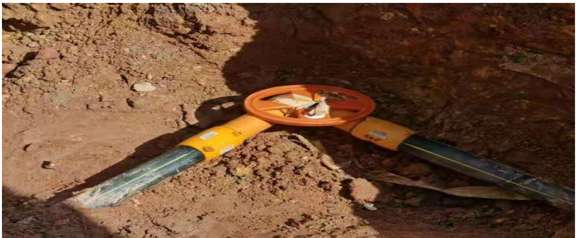
燃气泄漏管段情况
