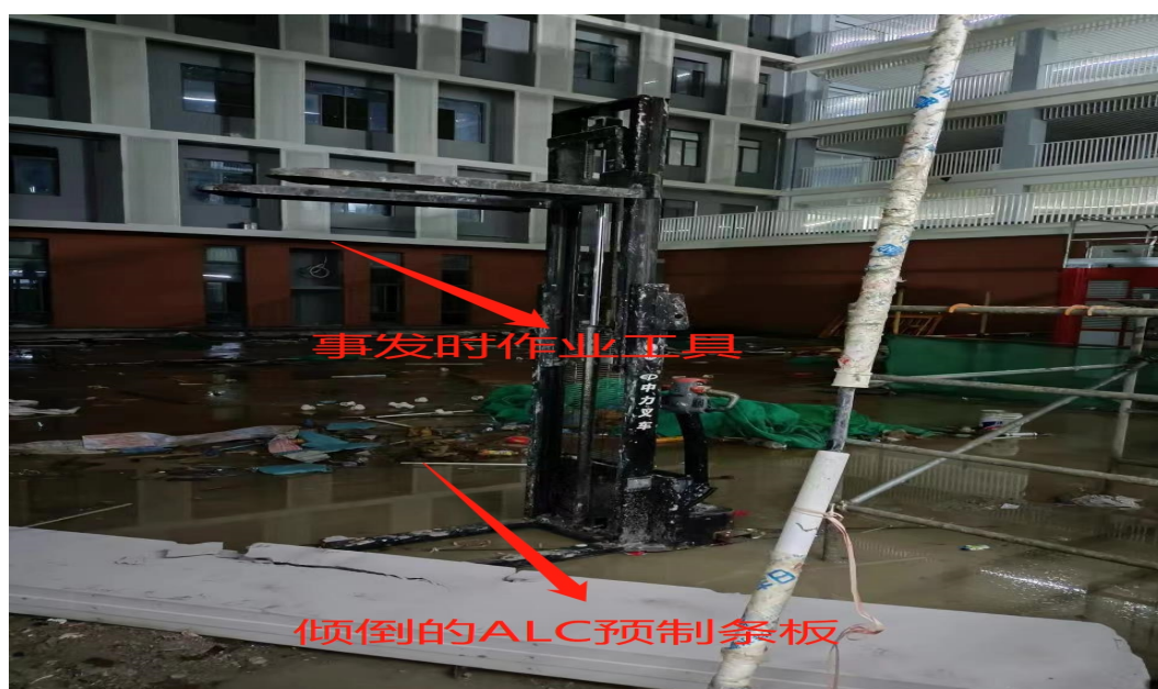
事故现场照片
