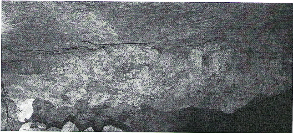
图6 事故现场矿体顶板的裂隙
