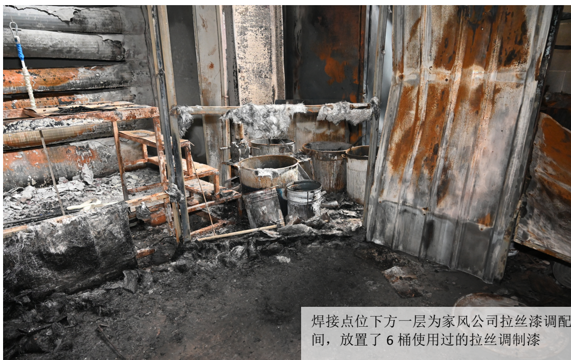
图六：家风公司电焊作业下方一楼拉丝漆调配间
