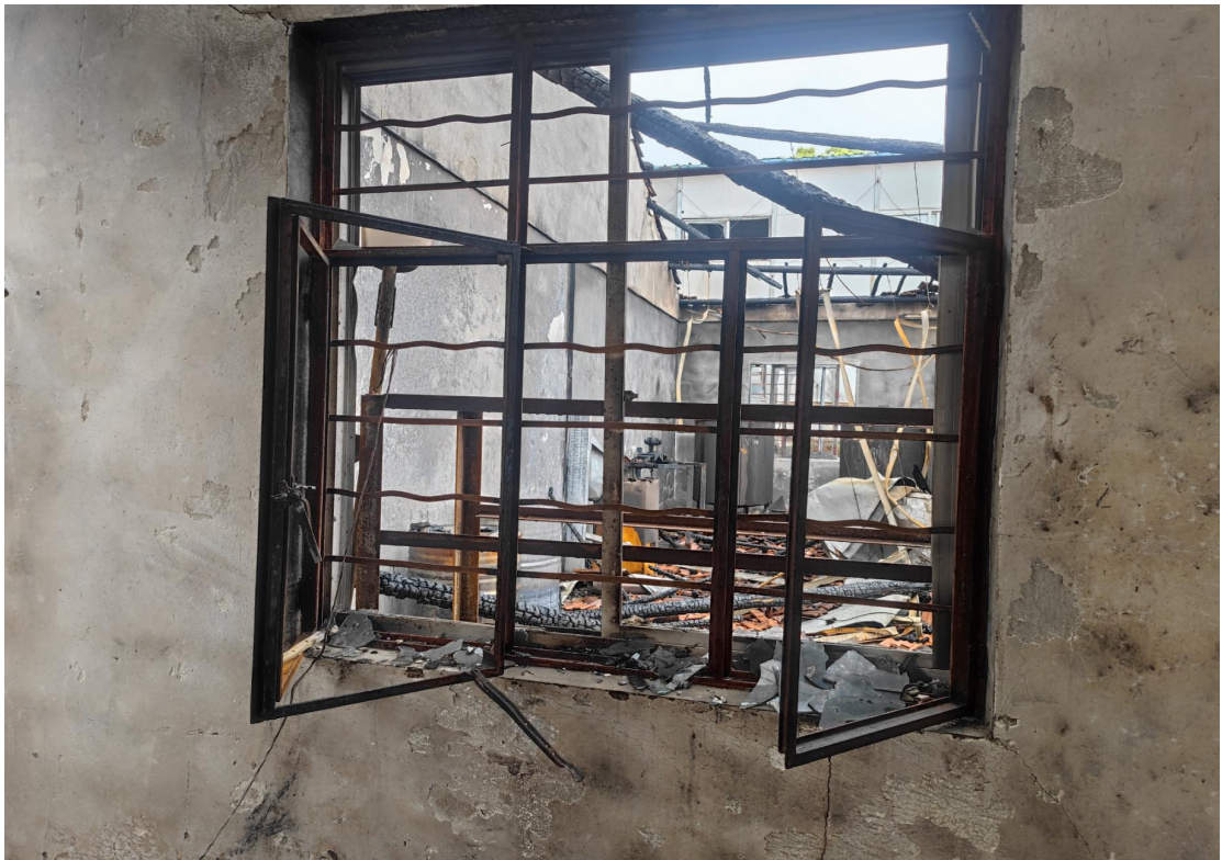
图 6 小车间窗户玻璃损毁情况
