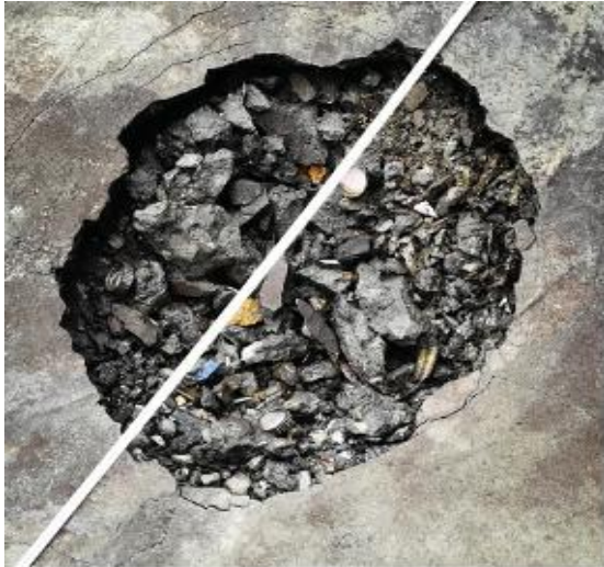
走廊通道路面椭圆形炸坑
