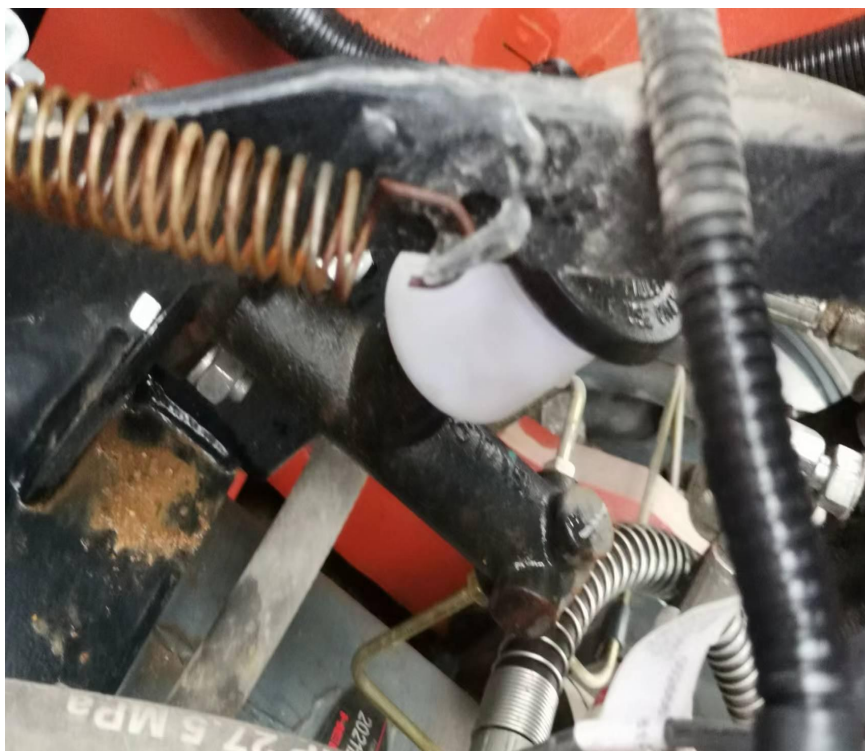
叉车制动液盒及管路无泄漏
