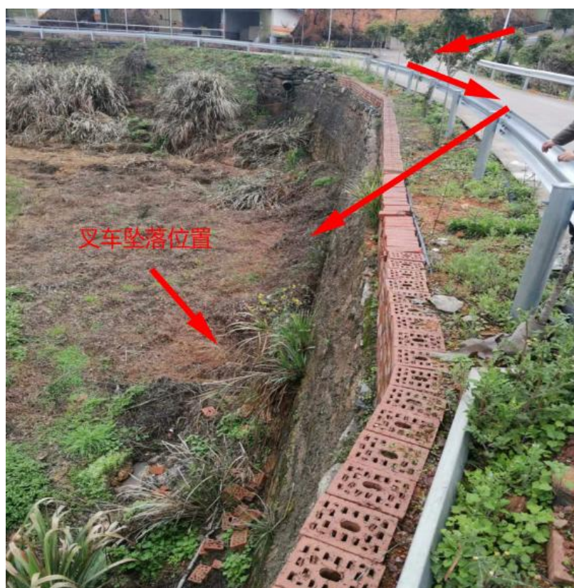
叉车行驶路线及坠落位置（路侧的路堤损坏，后期已修复并加装护栏）
