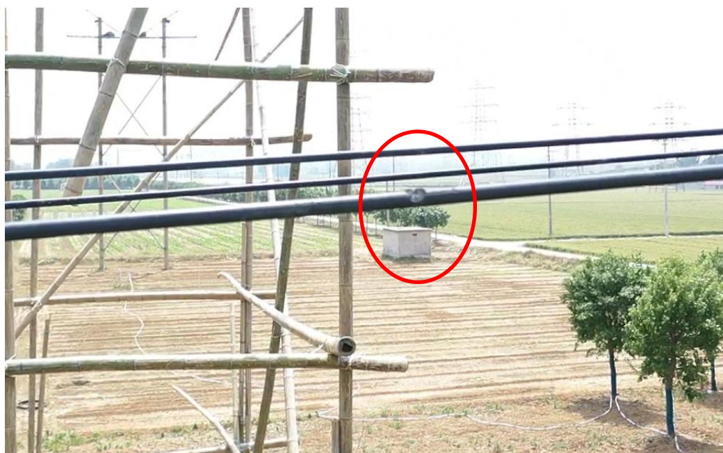
图1 10千伏夏屯线架空绝缘导线破损处
