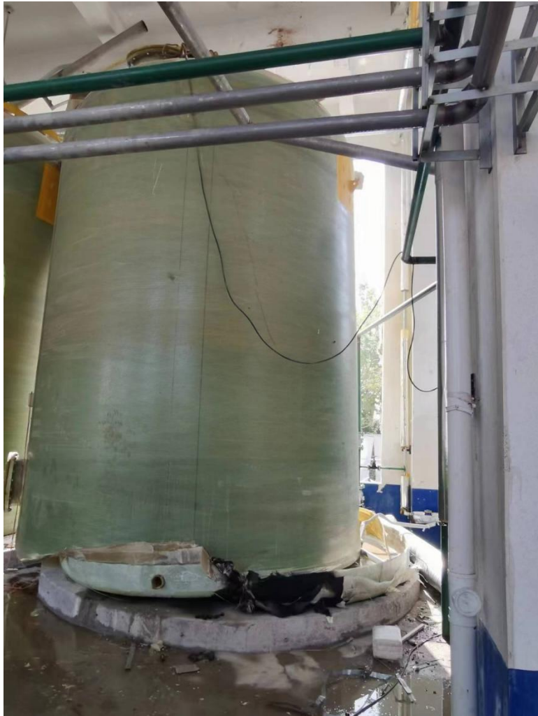
图 1 罐体炸裂情况
