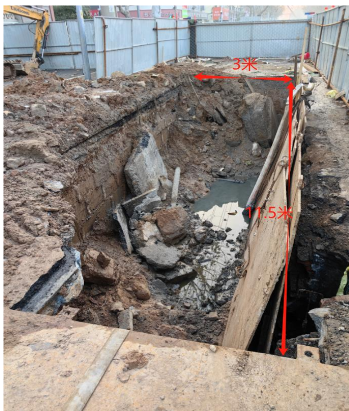
图 3 事发沟槽坍塌后情况
