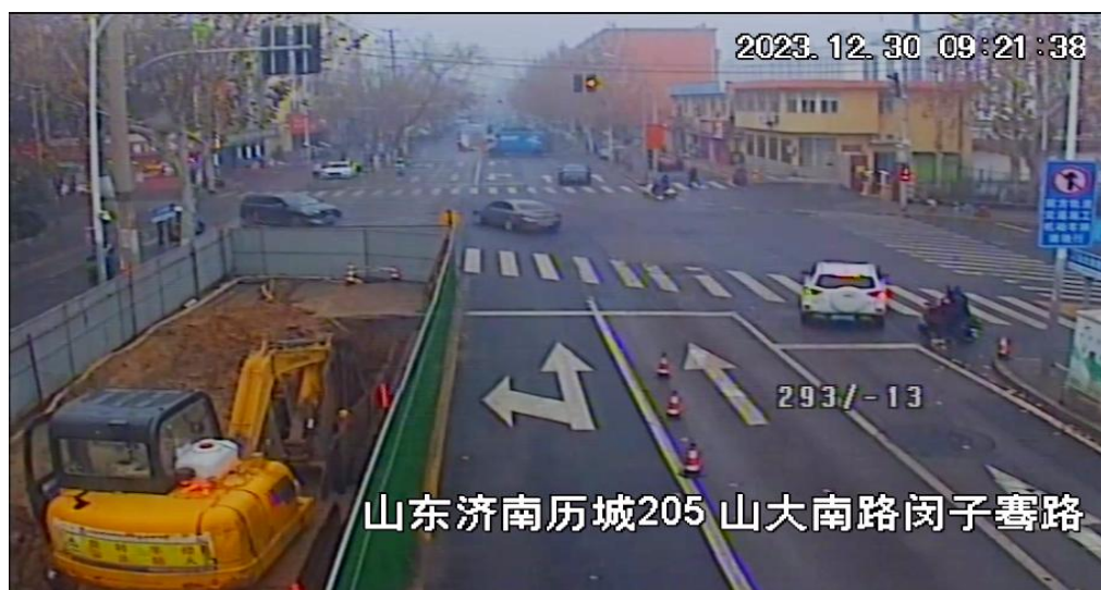
图1 事故现场坍塌前
