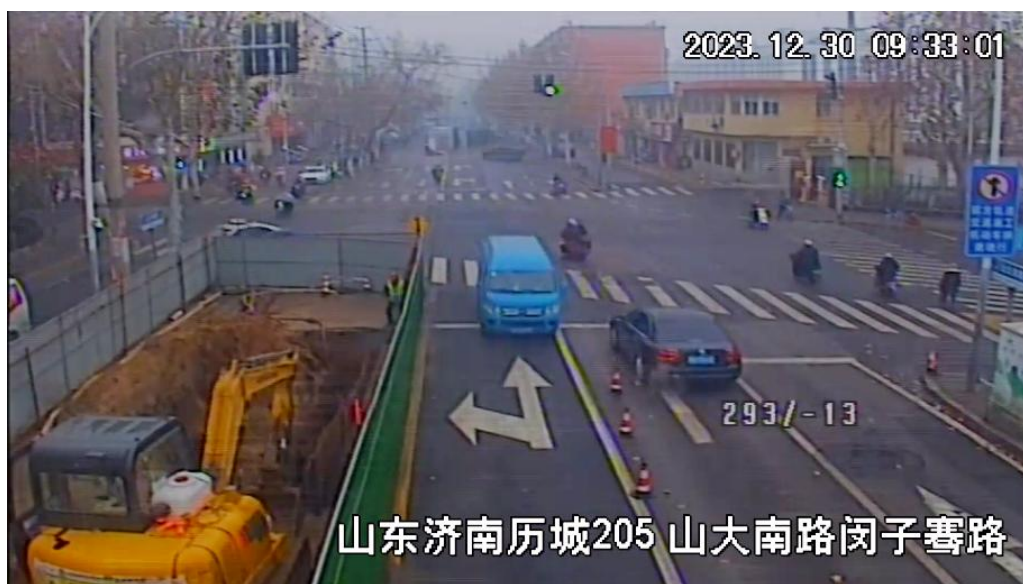
图 2 事故现场坍塌后
