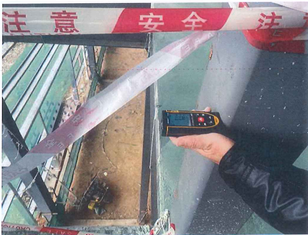
图 4 事故现场电梯井预留洞口尺寸测量
