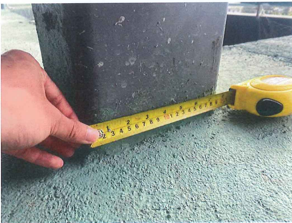
图 5 事故现场结构尺寸测量
