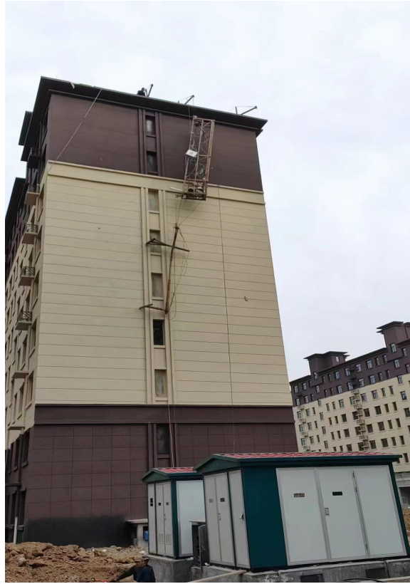
图 2 5 号楼吊篮倾覆图
