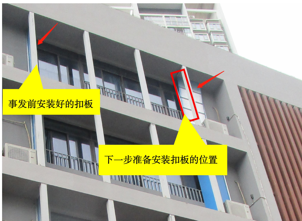
图 6：事发时装饰扣板安装情况
