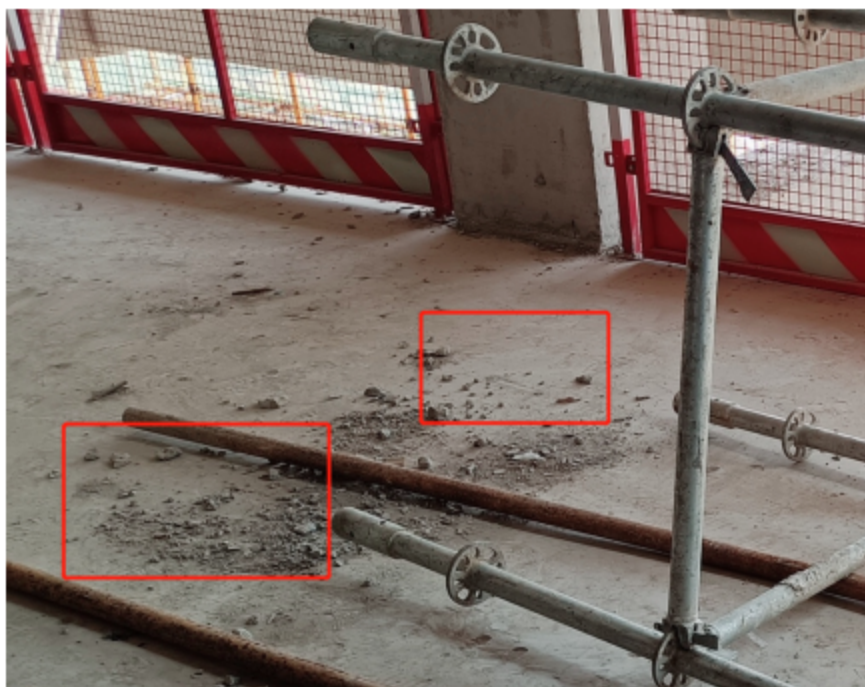
图9 移动操作平台倒伏时擦痕
