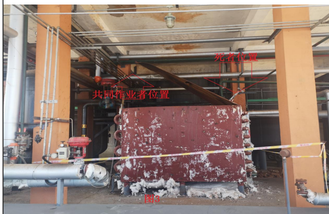
图2. 事故现场图片
