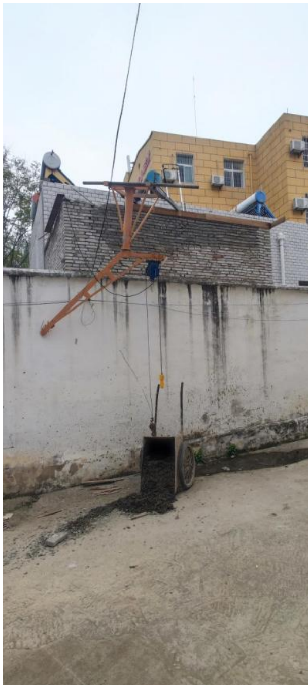
图2斗车掉落，鸡公吊悬挂围墙外侧
