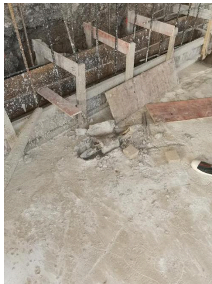
图4：嵌入混凝土地面的副钩照片
