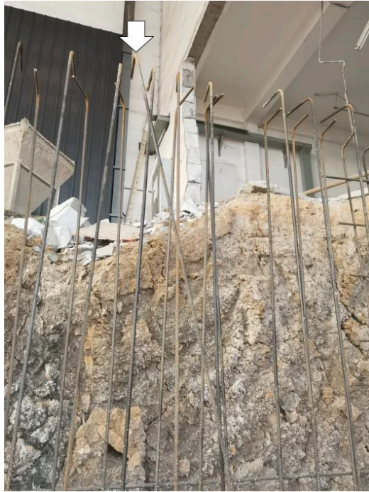
图5：被牵扯偏斜的钢筋照片（箭头处）
