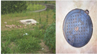
图4（W9污水检查井照片）
