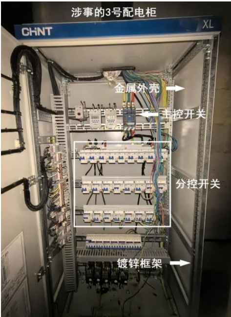
图3 3号配电柜内部结构
