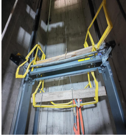
图 3：破损变形的作业平台护栏
