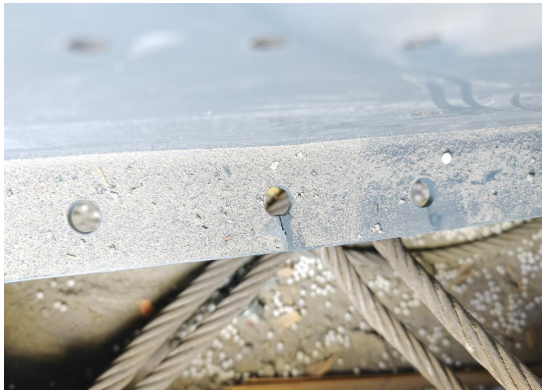
图 5：斜梁底部两侧勒痕
