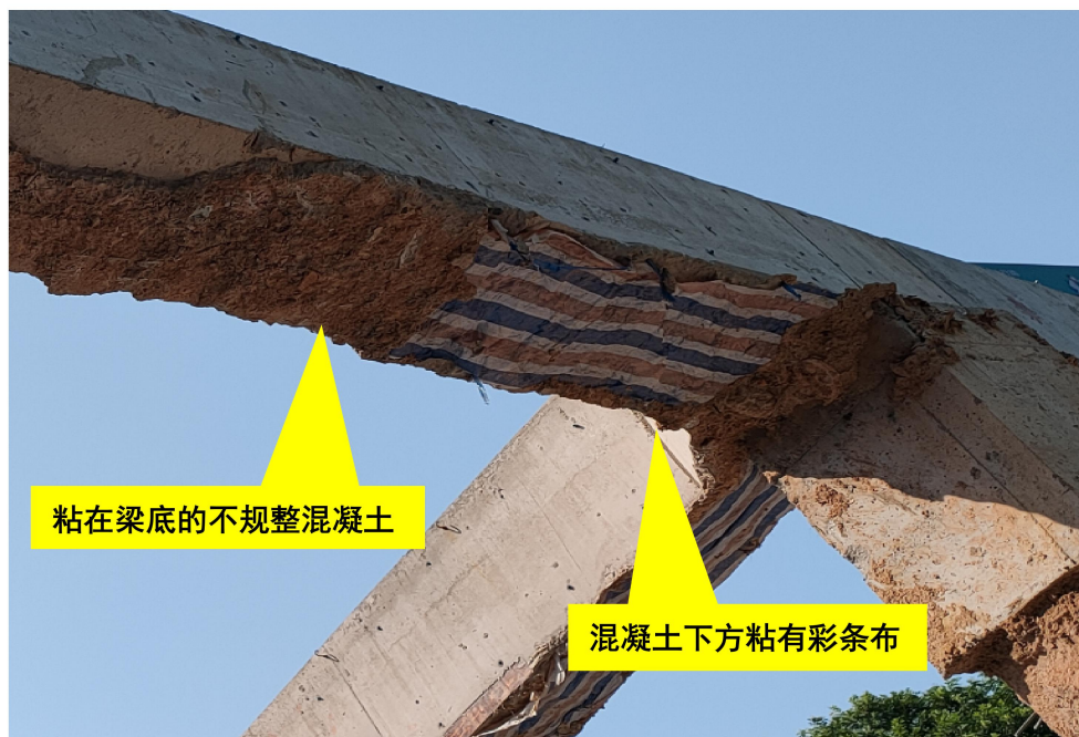
图 3：支撑梁底混凝土情况
