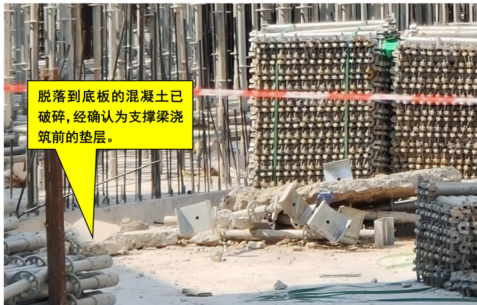
图 4：脱落的支撑梁底混凝土块
