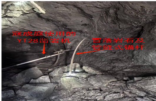
图 7 冒落现场凿岩机及空心锚杆
