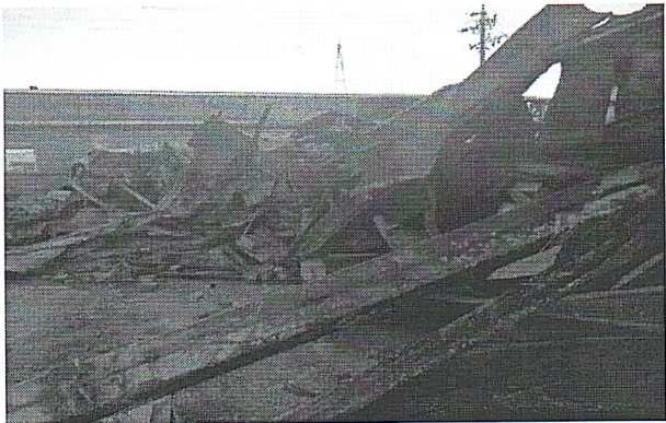
图 11 燃烧残留的屋架和铁皮
