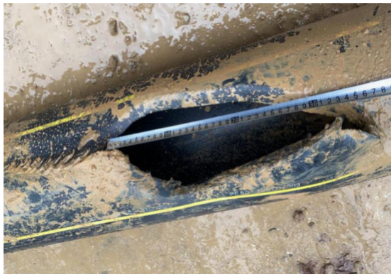
图7 燃气管道断面处
