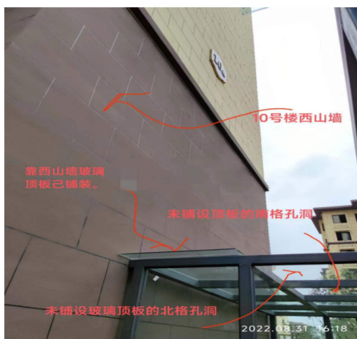
图 3—1 事故现场坠落环境图
