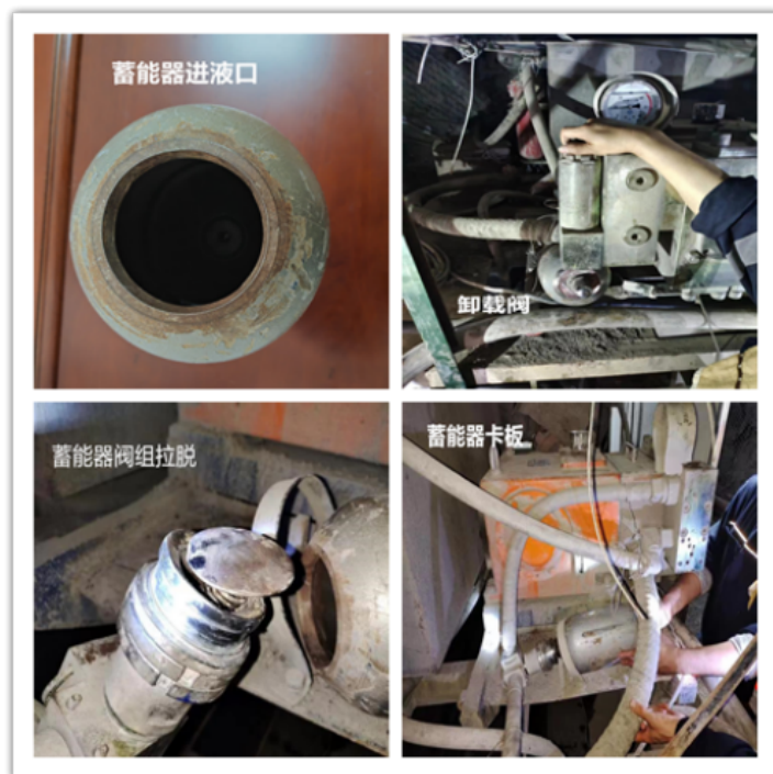
图4 事故现场损坏蓄能器及关联部件图
