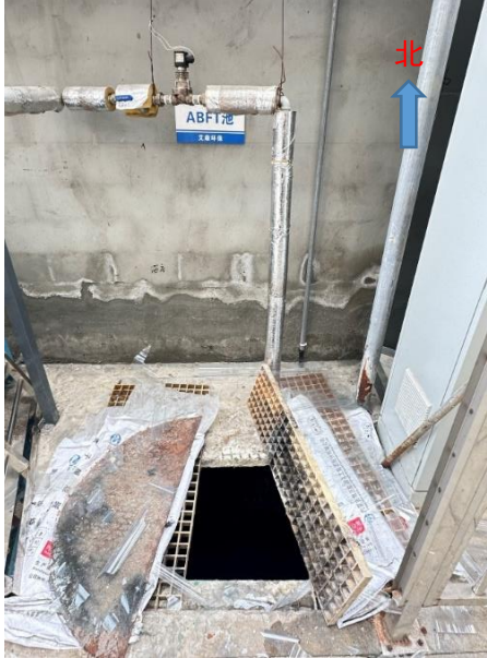
曝气生物流化池
