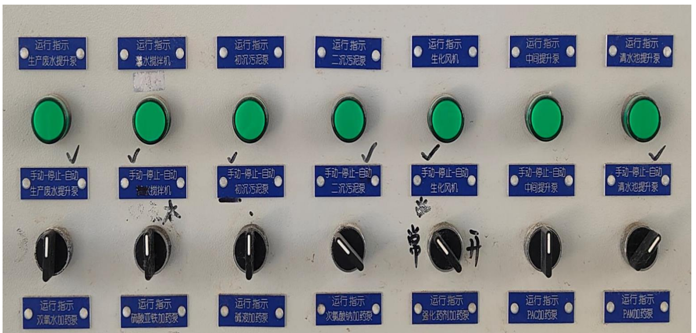
图 7 污水处理站总控制柜第一排控制图
