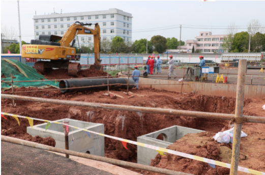
图4：事故发生后现场照片
